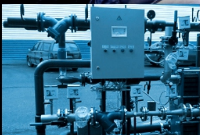
Индивидуальный тепловой пункт
